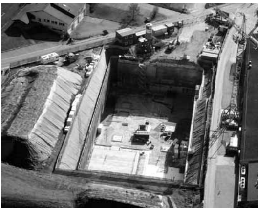
Le chantier Centre de Penthaz, vue aérienne du nord. À gauche, l'excavation de Penthaz II. À droite, le côté est du bâtiment de Penthaz I actuellement en service.
